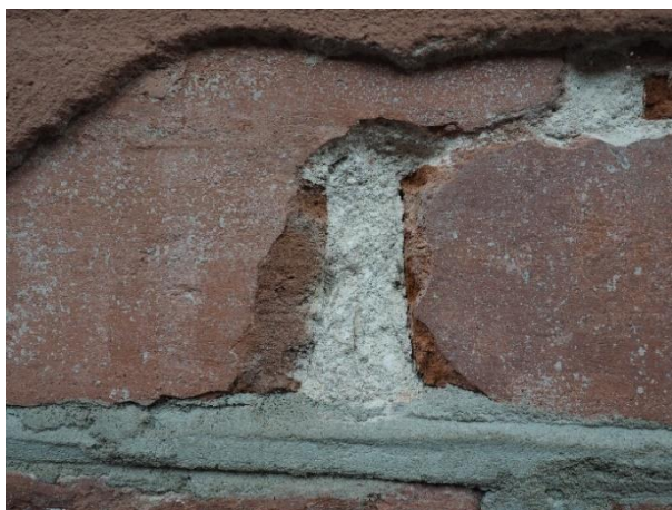
Zbliżenie odkrywki na powierzchni filara. Widoczna cienka warstewka, gładko opracowanej zaprawy w kolorze czerwonym, która przypuszczalnie stanowiła podkład pod dekorację malarską filarów. Na wierzchu wtórna zaprawa (z XX w.)
