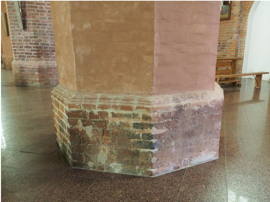
30. Bazylika Mniejsza pw. Św. Katarzyny Aleksandryjskiej w Braniewie, wnętrze, strona południowa, cokół drugiego filaru od zachodu. Widoczny stan lica ceglanoego, wtórne uzupełnienia zaprawami cementowymi.
