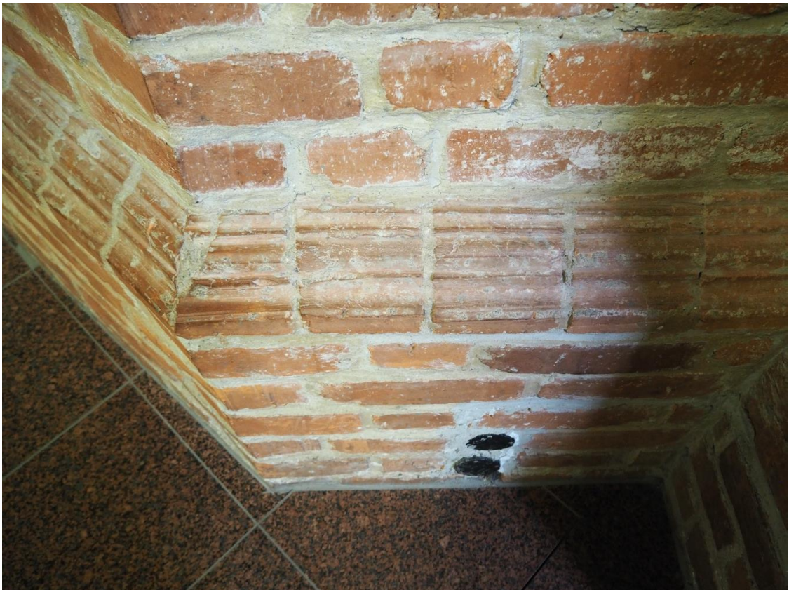
45. Bazylika Mniejsza pw. Św. Katarzyny Aleksandryjskiej w Braniewie, wnętrze, strona północna, cokół pierwszego filaru od zachodu. Widoczny stan spoin; nieestetycznie poprowadzona elektryka.
