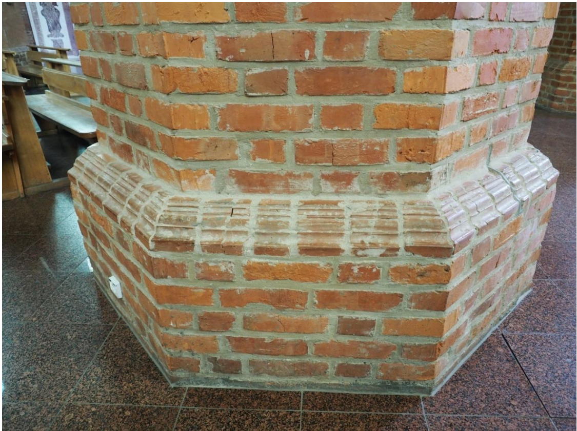
47. Bazylika Mniejsza pw. Św. Katarzyny Aleksandryjskiej w Braniewie, wewnątrz, strona północna, cokół drugiego filaru od zachodu. Widoczne nieestetyczne spoinowanie zaprawą cementową.
