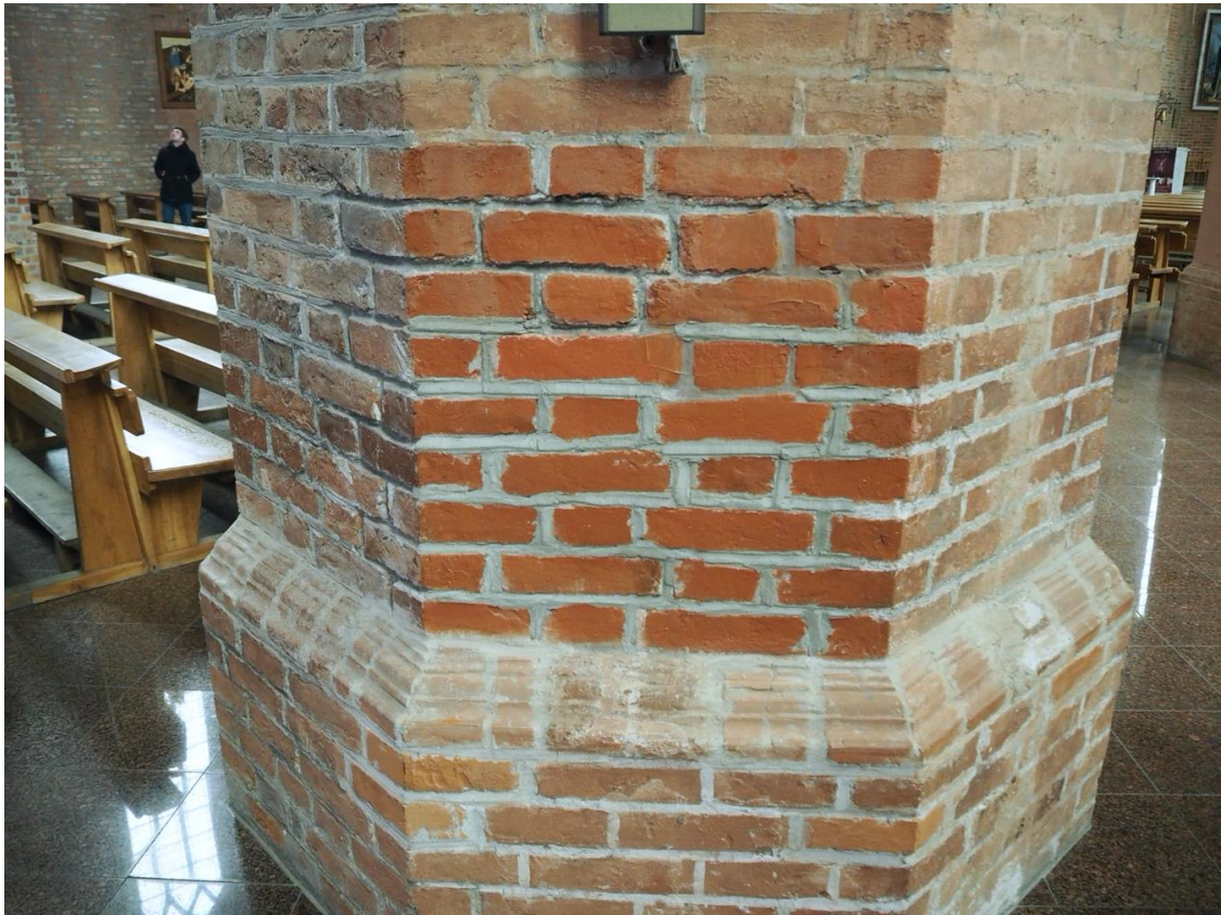
33. Bazylika Mniejsza pw. Św. Katarzyny Aleksandryjskiej w Braniewie, wnętrze, strona południowa, trzeci filar od zachodu. Widoczne nieestetyczne uzupełnienia materiału ceramicznego; wtórne spoiny cementowe.
