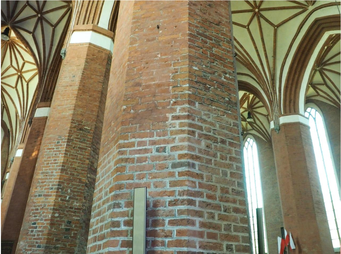
48. Bazylika Mniejsza pw. Św. Katarzyny Aleksandryjskiej w Braniewie, wewnątrz, strona północna, trzeci filar od zachodu. Widoczne spoinowanie zaprawą cementową.
