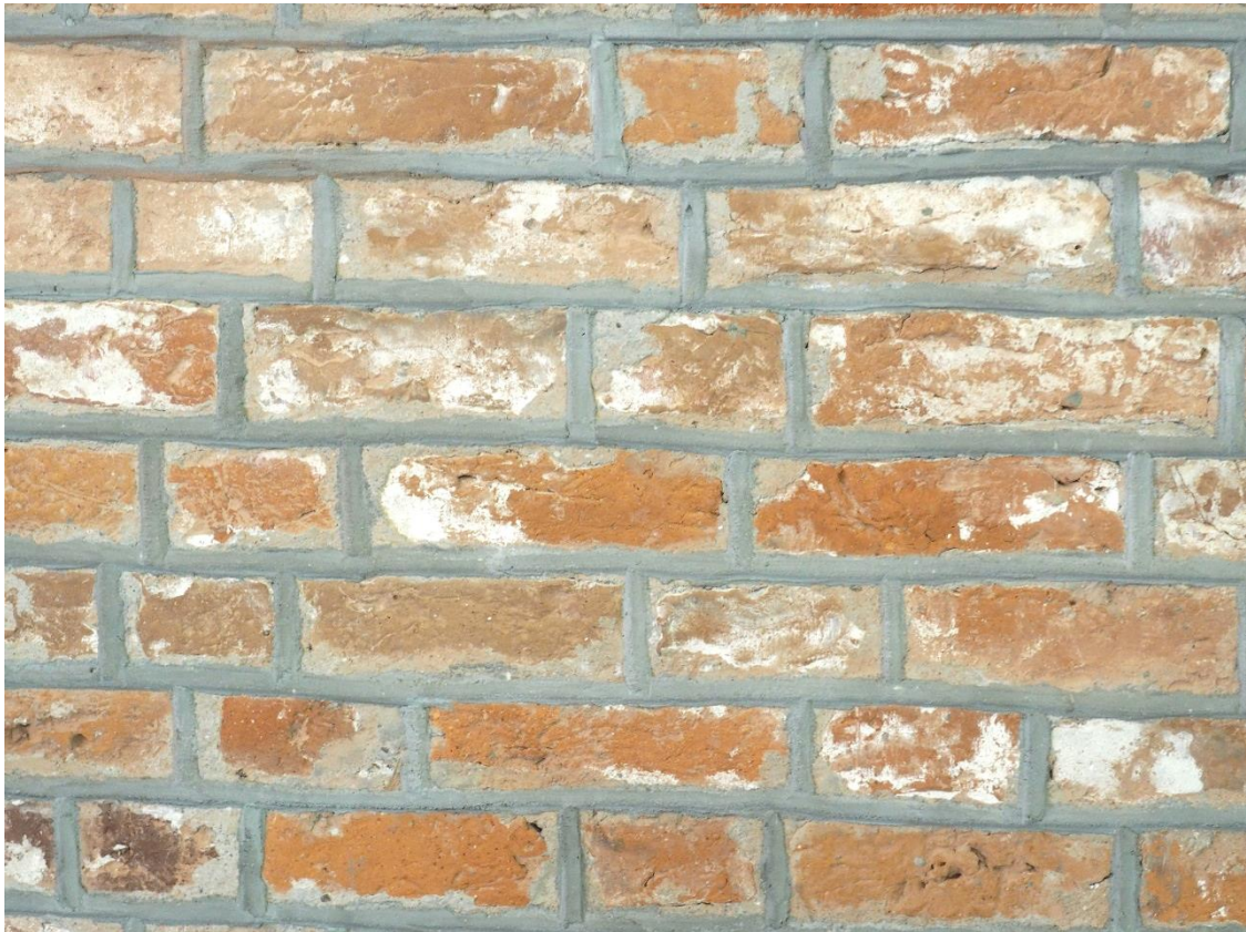
76. Bazylika mniejsza pw. Św. Katarzyny Aleksandryjskiej w Braniewie, wnętrze, ściana południowa. Widoczne nieestetyczne spoinowanie zaprawą cementową; relikty pobiałą.
