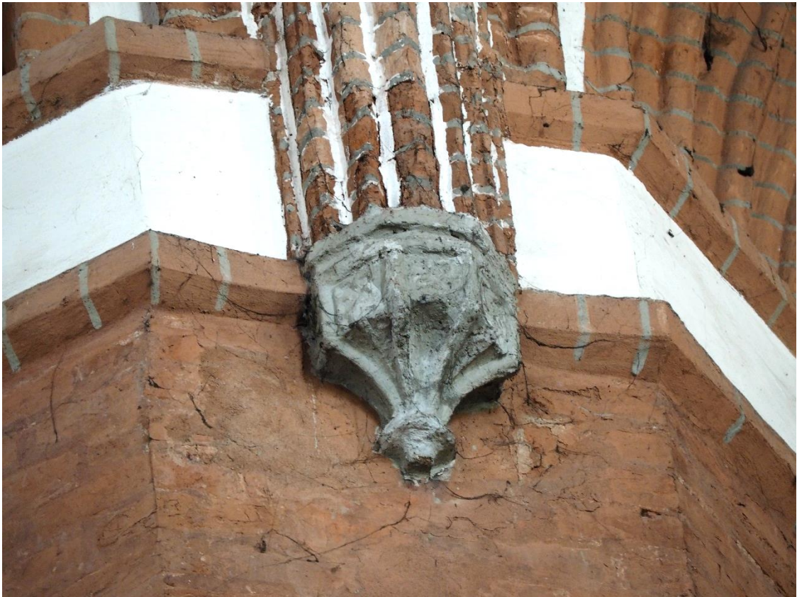
59. Bazylika Mniejsza pw. Św. Katarzyny Aleksandryjskiej w Braniewie, wnętrze, strona północna. Widoczna częściowo uszkodzona, maswerkowa konsola słupek.
