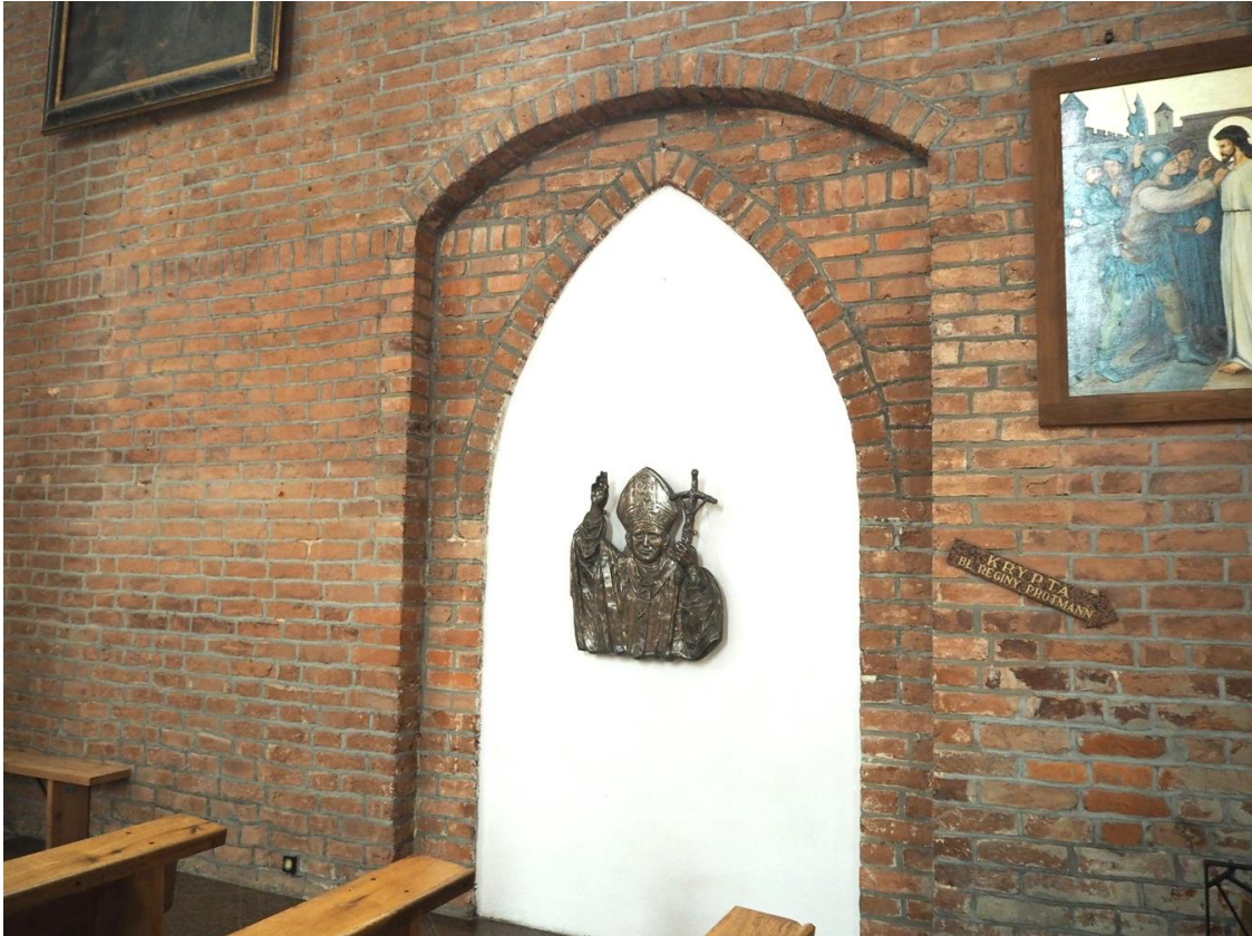
75. Bazylika Mniejsza pw. Św. Katarzyny Aleksandryjskiej w Braniewie, wnętrze, ściana południowa. Widoczny zamurowany otwór drzwiowy; uzupełnienia lica ceglanego i zapraw.
