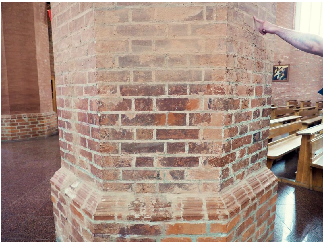
31. Bazylika Mniejsza pw. Św. Katarzyny Aleksandryjskiej w Braniewie, wnętrze, strona południowa, trzeci filar od zachodu. Widoczny stan lica ceglanoego z zachowanymi śladami polichromii.
