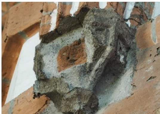
Uszkodzona konsola. Widoczny ceramiczny rdzeń gipsowego odlewu oraz struktura sztucznego kamienia gipsowego na przełamie i prostokątna płytina – tło gipsowego elementu.
