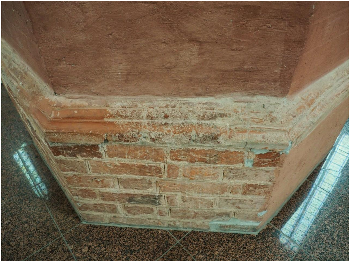
42. Bazylika Mniejsza pw. Św. Katarzyny Aleksandryjskiej w Braniewie, wnętrze, strona południowa, cokół szóstego filaru od zachodu. Widoczne opracowanie zwieńczenia cokołu; opracowanie spoin.
