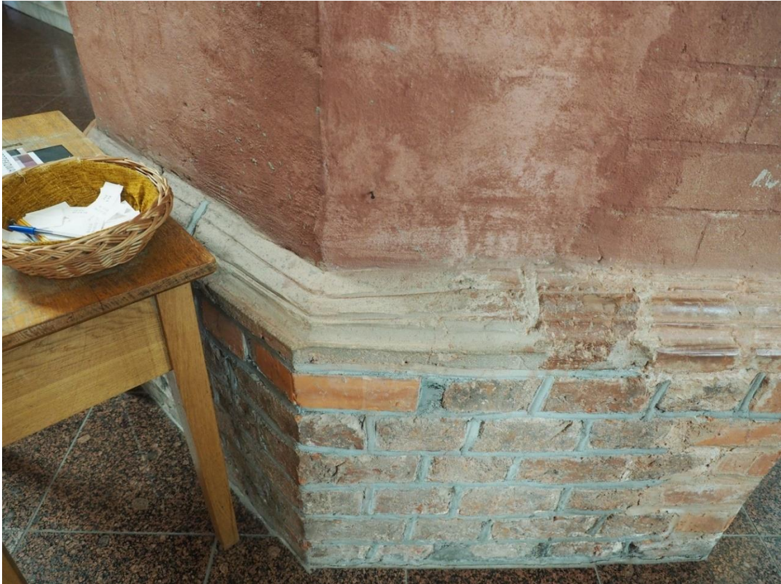
54. Bazylika Mniejsza pw. Św. Katarzyny Aleksandryjskiej w Braniewie, wewnątrz, strona północna, szósty filar od zachodu. Widoczne wtórne zwieńczenie cokołu; nieestetyczne spoinowanie zaprawą cementową.
