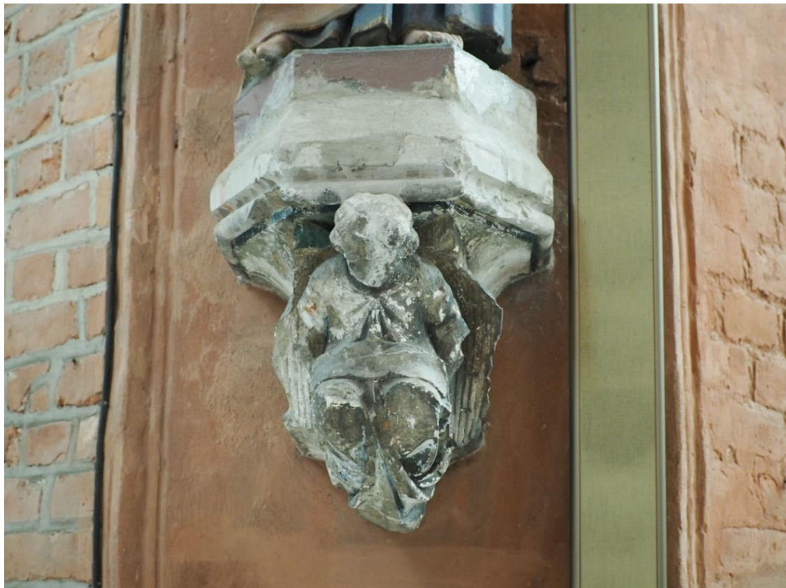
63. Bazylika Mniejsza pw. Św. Katarzyny Aleksandryjskiej w Braniewie, wnętrze, strona południowa. Widoczna konsola figuralna z przedstawieniem anioła na siódmym filarze od zachodu; ubytki; relikty polichromii.
