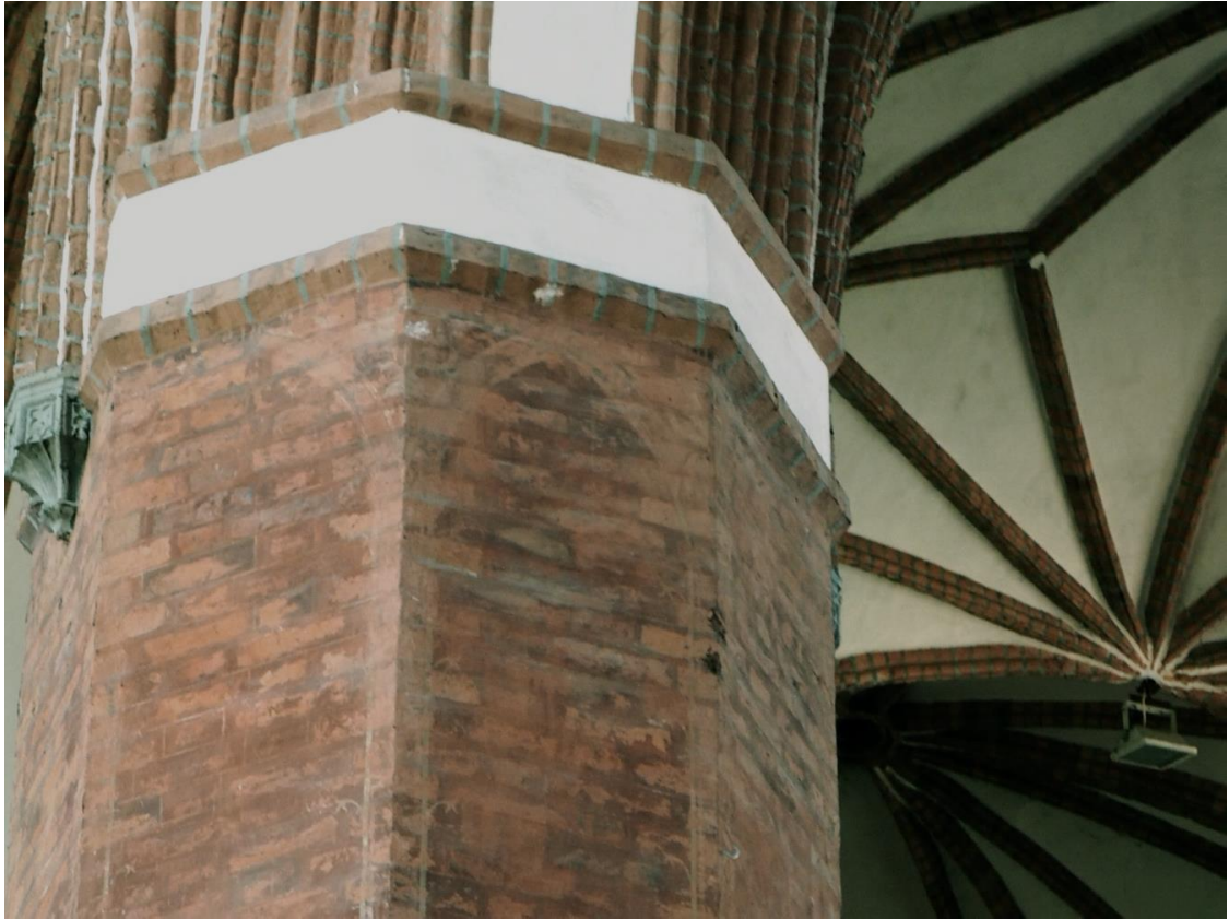
34. Bazylika Mniejsza pw. Św. Katarzyny Aleksandryjskiej w Braniewie, wnętrze, strona południowa, trzeci filar od zachodu. Widoczne ślady polichromii – wici zwieńczone trójliściami; zwieńczenia lancet.
