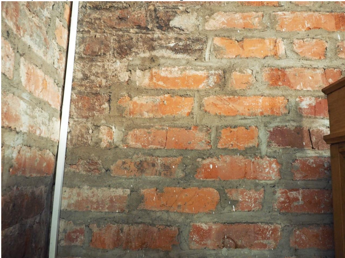
29. Bazylika Mniejsza pw. Św. Katarzyny Aleksandryjskiej w Braniewie, wewnątrz, zachodnia ściana korpusu, poniżej empory organowej. Widoczne wtórne zaprawy cementowe; przelicowanie muru.
