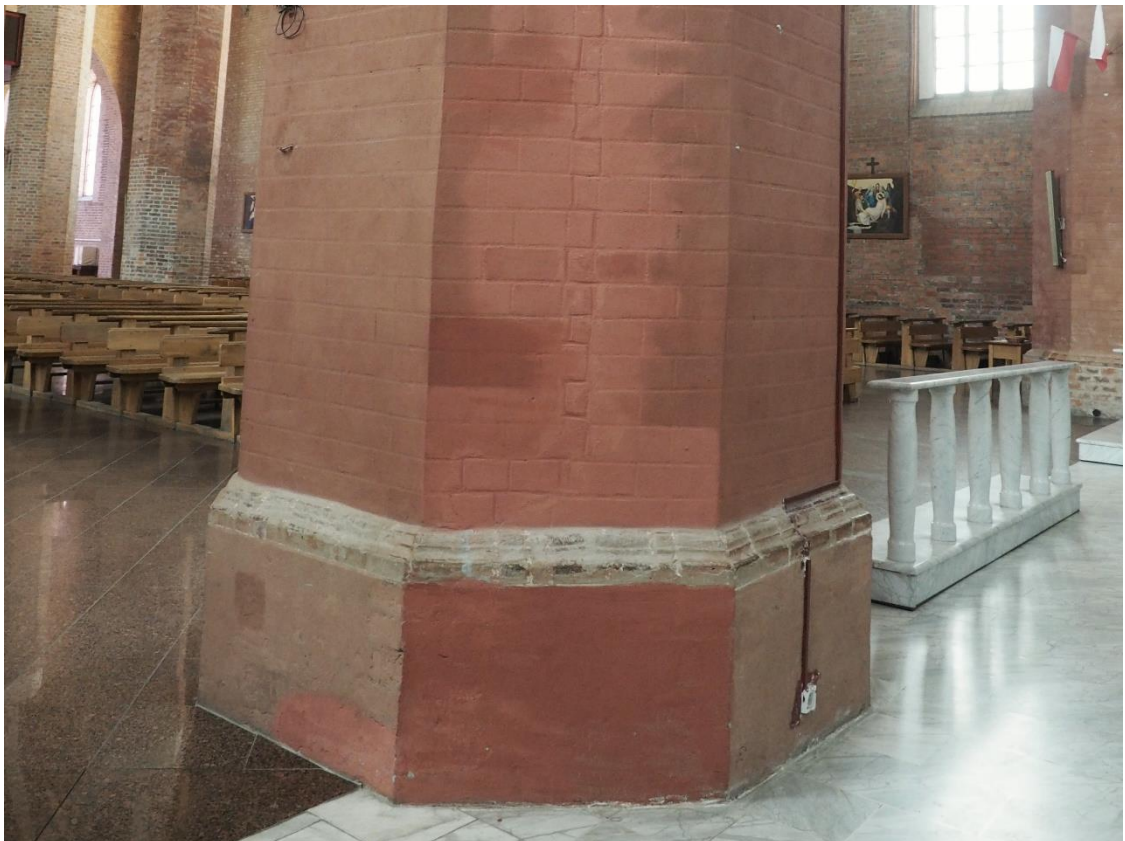
41. Bazylika Mniejsza pw. Św. Katarzyny Aleksandryjskiej w Braniewie, wnętrze, strona południowa, szósty filar od zachodu. Widocznie nieestetycznie poprowadzone przewody elektryczne; zróżnicowanie barwne lica.
