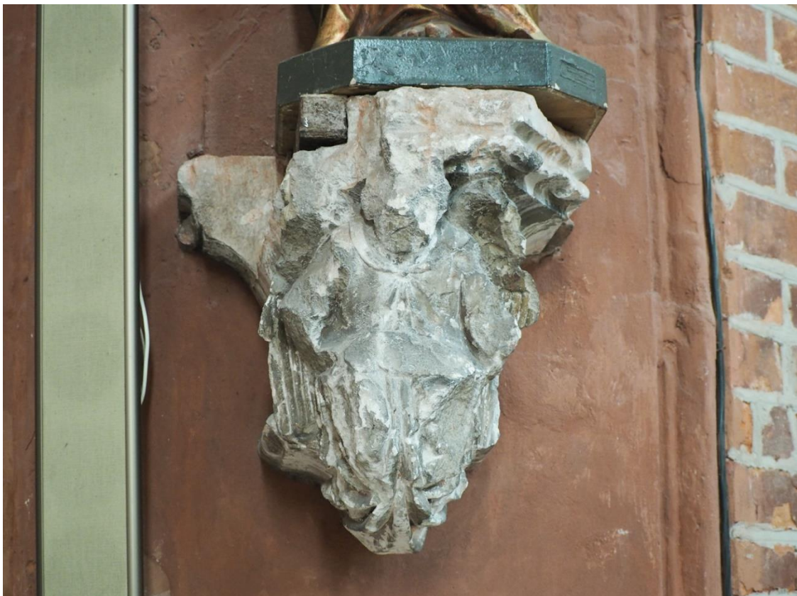
65. Bazylika Mniejsza pw. Św. Katarzyny Aleksandryjskiej w Braniewie, wnętrze, strona północna. Widoczna konsola figuralna z przedstawieniem anioła na siódmym filarze od zachodu; ubytki.
