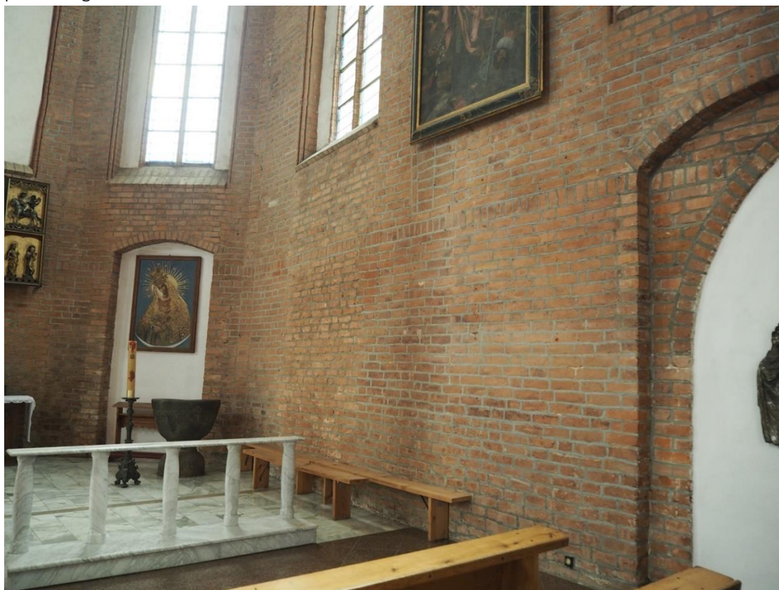
23. Bazylika Mniejsza pw. Św. Katarzyny Aleksandryjskiej w Braniewie, wewnątrz, prezbiterium, widok od północnego zachodu. Widoczne przemurowania; zakończenie etapu budowy warstwą cegieł „na rolkę”.
