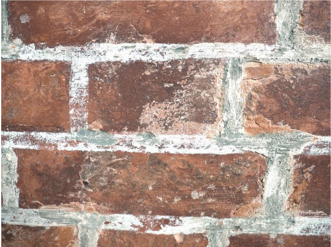
32. Bazylika Mniejsza pw. Św. Katarzyny Aleksandryjskiej w Braniewie, wnętrze, strona południowa, trzeci filar od zachodu - detal. Widoczny stan lica ceglanego z zachowanymi śladami polichromii.
