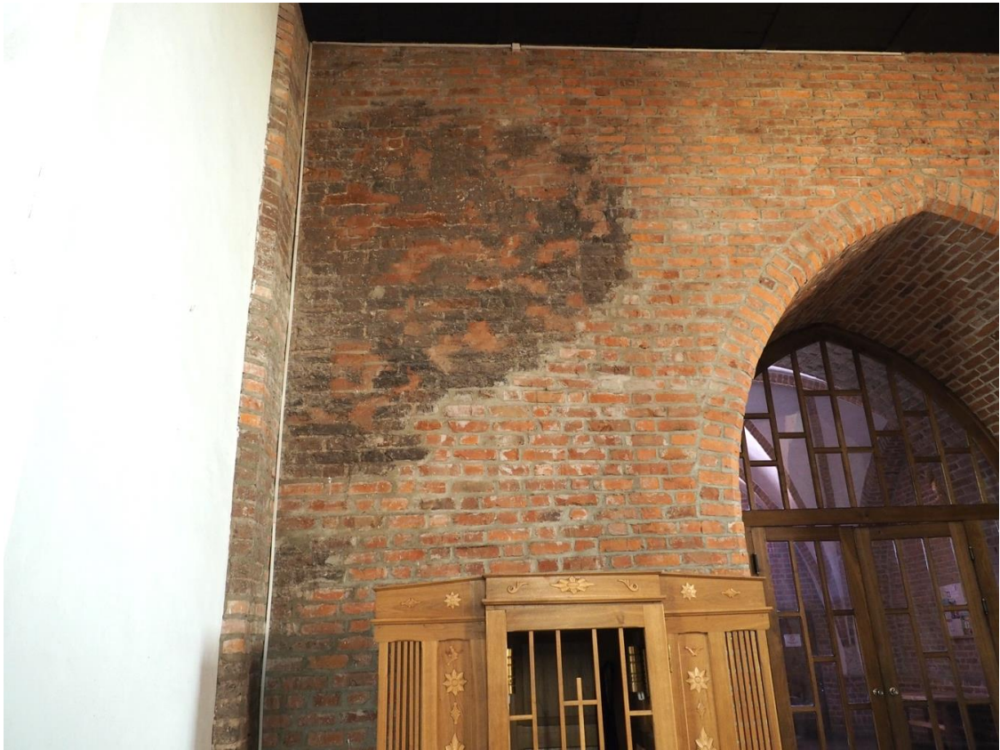
28. Bazylika Mniejsza pw. Św. Katarzyny Aleksandryjskiej w Braniewie, wewnątrz, zachodnia ściana korpusu, poniżej empory organowej. Widoczny stan lica ceglanego; wtórne spoiny cementowe; nieestetyczne uzupełnienia materiału ceramicznego.
