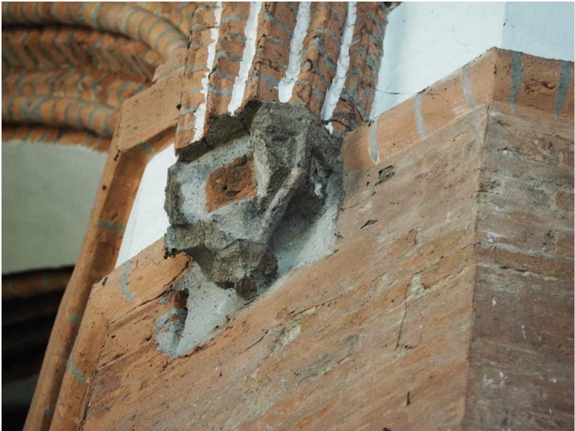
57. Bazylika Mniejsza pw. Św. Katarzyny Aleksandryjskiej w Braniewie, wewnątrz, strona północna. Widoczna uszkodzona konsola słupek; ceramiczny rdzeń odlewu gipsowego; sztuczny kamień.
